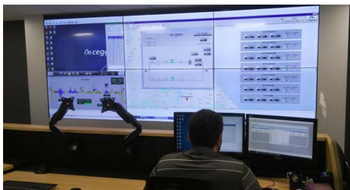
CCO da CEGÁS onde a VECTOR está implantando o sistema SCADA
